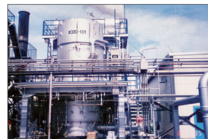
焼 却 物:スラリー廃液、汚泥 焼却能力:1600kg/Hr
