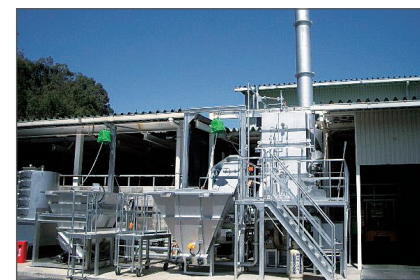
焼 却 物:牛血液、汚泥、スクリーン滓 焼却能力:195kg/Hr
