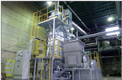
燃 焼 物:乾燥汚泥 燃焼能力:48kg/Hr
